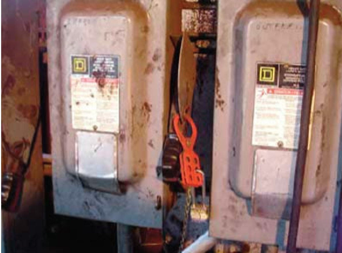
Figura 1. Esta fotografía ilustra la sala sur de la descortezadora donde la víctima había bloqueado dos de los circuitos eléctricos [Foto cortesía de SCOSHA].
