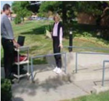
Figure 7.3 Pasamanos discontinuo muy bajo para ser usado por los peatones.
