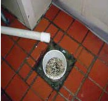
Figura 2.1 Tubería no alineada correctamente con el desagüe ocasiona un estancamiento de agua en el piso.
