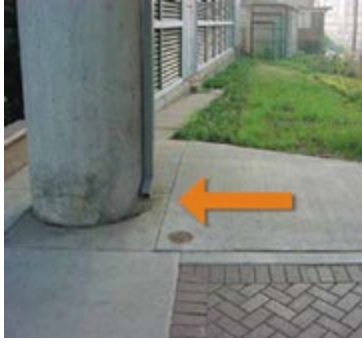
Figure 2.4 Tubería de desagüe vertiendo agua a una acera.
