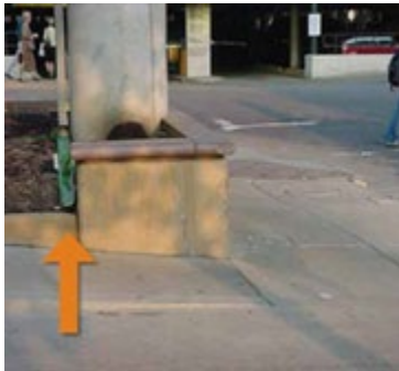
Figura 2.5a Tubería de desagüe vertiendo agua a una acera inclinada (vista frontal).
