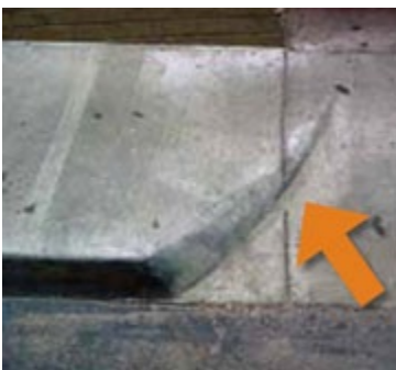
Figura 4.2 Área de pavimento a desnivel que debería estar señalada con pintura de seguridad amarilla.
