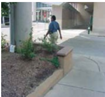
Figura 2.5c Tubería de desagüe corregida. El agua fue desviada debajo de la tierra hacia la tubería del drenaje y el desagüe ya no da a la acera.
