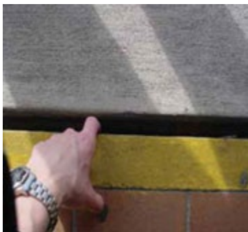
Figura 4.5 Separación grande (mayor de ½") en un pasillo afuera del edificio del hospital.
