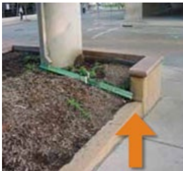
Figura 2.5b Tubería de desagüe vertiendo agua a una acera inclinada (vista lateral).
