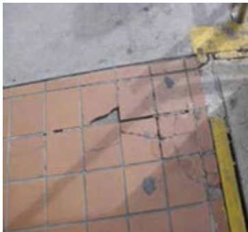
Figura 4.4 Baldosas quebradas en un pasillo afuera del edificio del hospital.
