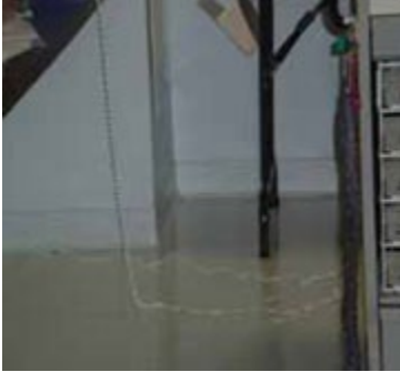
Figura 9.1 Cable de teléfono suelto.
