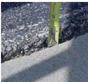
Figura 4.6 Cambio en elevación (mayor de ½") en un pasillo afuera del edificio del hospital.
