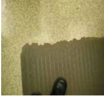
Figura 10.1 Borde de tapete no está plano sobre el suelo.
