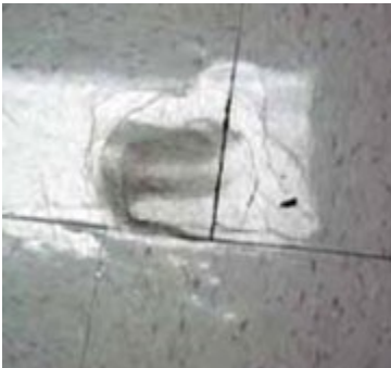
Figura 3.2 Baldosas de vinilo abolladas.
