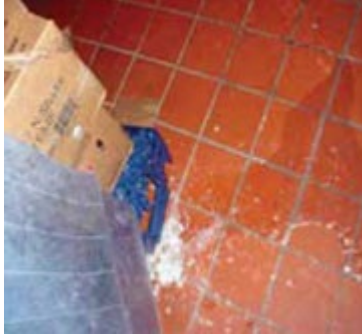
Figura 1.2 Agua en el piso saliendo de una tubería.
