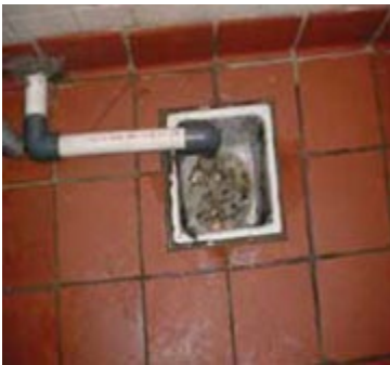
Figura 2.2 Desagüe parcialmente taponado con desechos.
