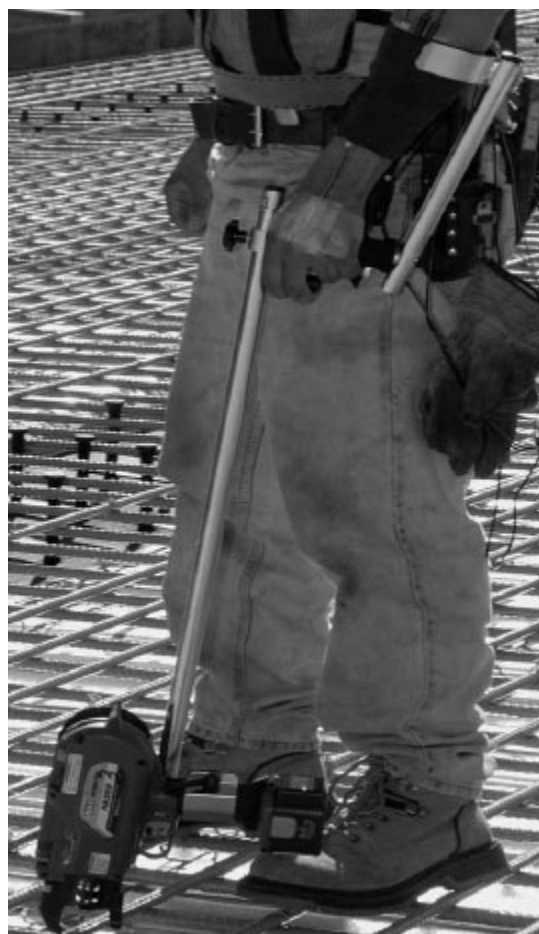
Figura 3 Atado de barras de armadura para concreto mediante el uso de una herramienta motorizada MAX-USA RB-392 con mango de extensión ajustable.
