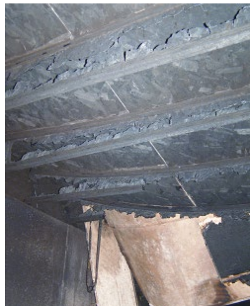
Figura 3 Vigas doble T dañadas por el fuego desde donde cayeron las víctimas. Observe cómo el alma vertical está casi completamente consumido [NIOSH 2006a].
