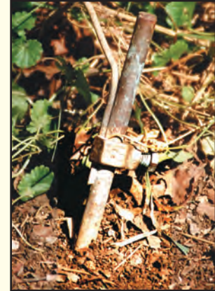
toma de tierra enterrada
