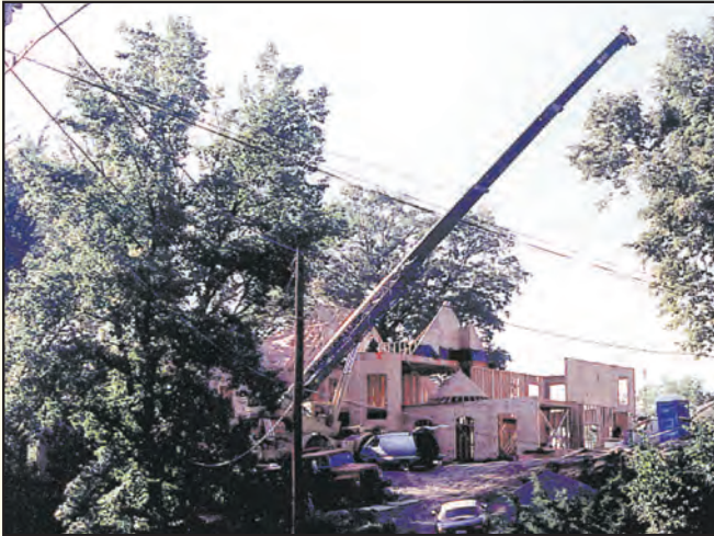
Es muy peligroso operar una grúa cerca de cables aéreos.
